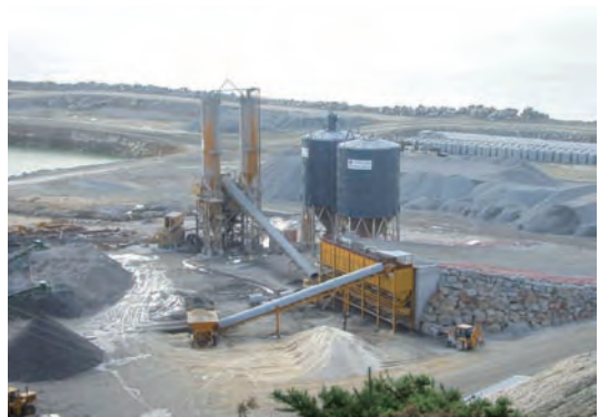
Figura 5.4 B Planta de fabricación de hormigón
